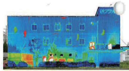
熱画像による建物のタイルの不具合部分抽出
