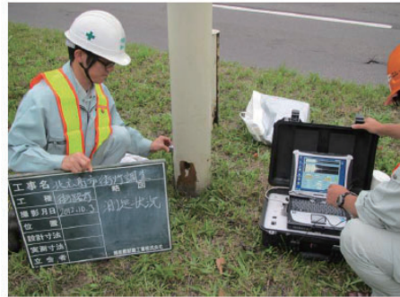
街路灯腐食調査
