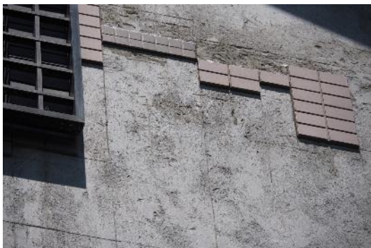
タイルが剥落した図書館外壁
