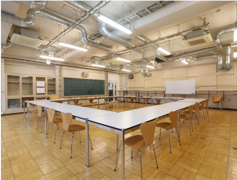
旧音楽室を会議室として利用（天井には空調と照明を新規に更新）
