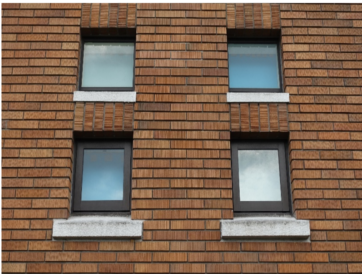
外壁の建具と納まりは既存デザインを継承（サッシは新規に更新）
